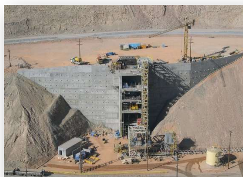
Britador, Mina Toquepala, Peru
