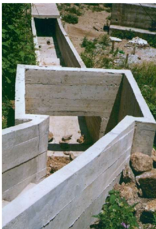
Figura 2.11 - Caixa de passagem (GeoRio)
