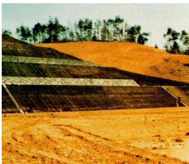
Figura 2.29 - Vista geral de talude protegido com geomanta (MacGuide, 1999)
