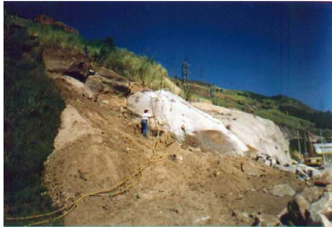
Figura 5.3 - Remoção de blocos após deslizamento na Linha Amarela, Rio de Janeiro
