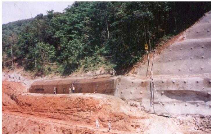
Figura 4.4 - Fases executivas em solo grampeado: da esquerda para à direita: escavação, instalação dos grampos e contenção pronta (Linha Amarela, RJ)
