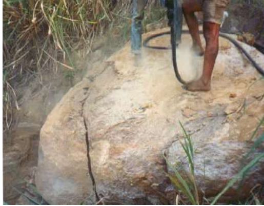
Figura 5.2 - Fragmentação de bloco
